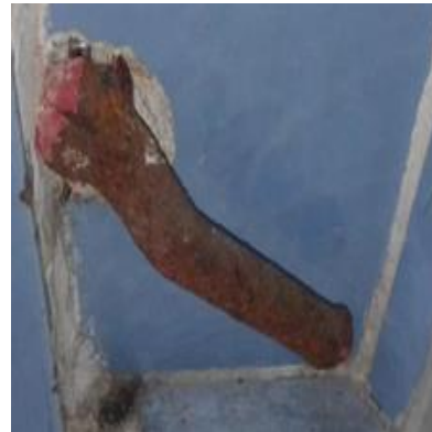
Fotografía 5. Llave de paso Galvanizado en mal estado
