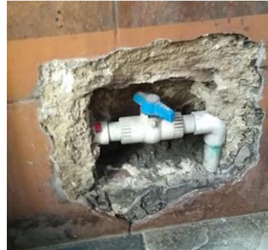
Fotografía 4. llave de paso en mal estado
