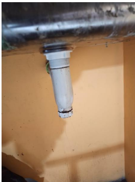
Fotografía 16.lavaplatos con fuga mínima en la tubería
