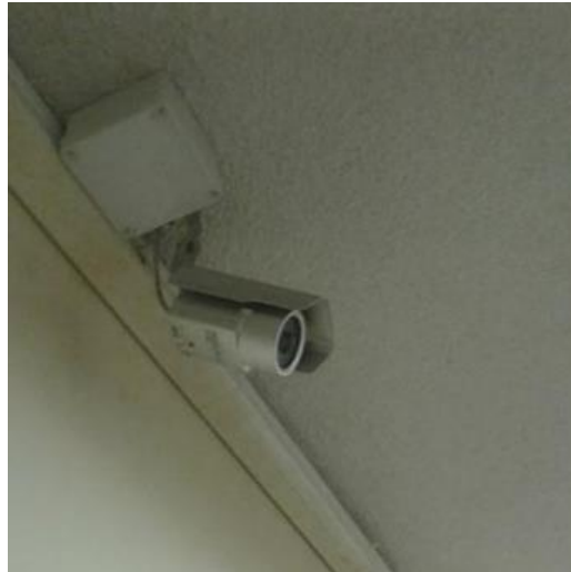
Fotografía 27. Cámara de seguridad
