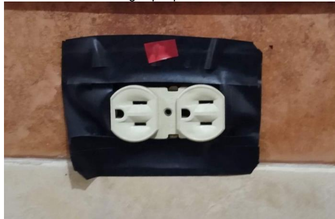
Fotografía 28. Tomacorriente sin tapa
