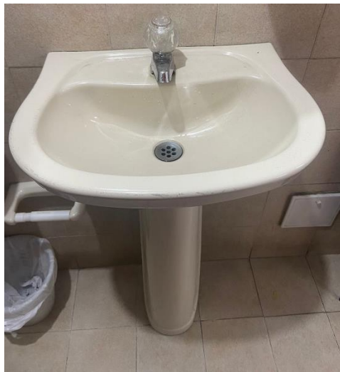
Fotografía 19. Lavamos en buen estado
