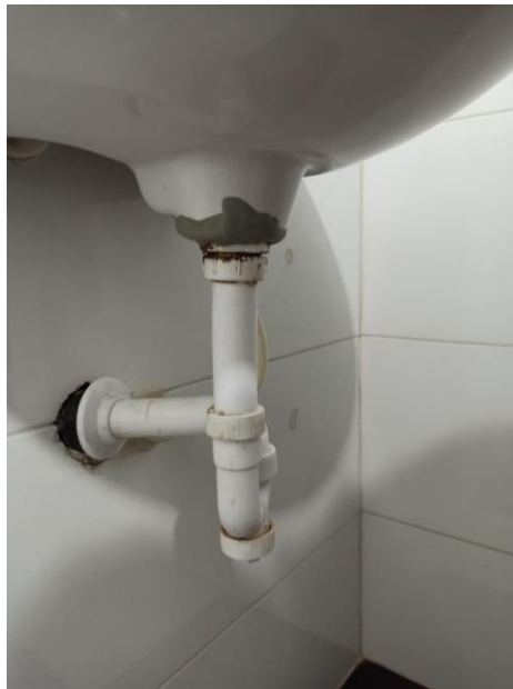
Fotografía 17. Lavamanos fuera de servicio
