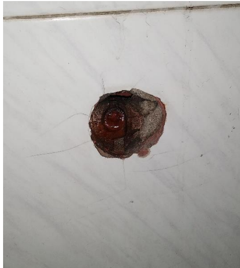
Fotografía 15. Llave de paso en hierro galvanizado
