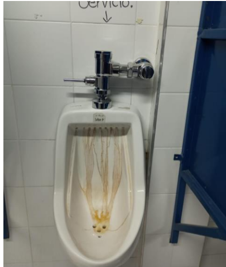
Fotografía 18. Orinal fuera de servicio
